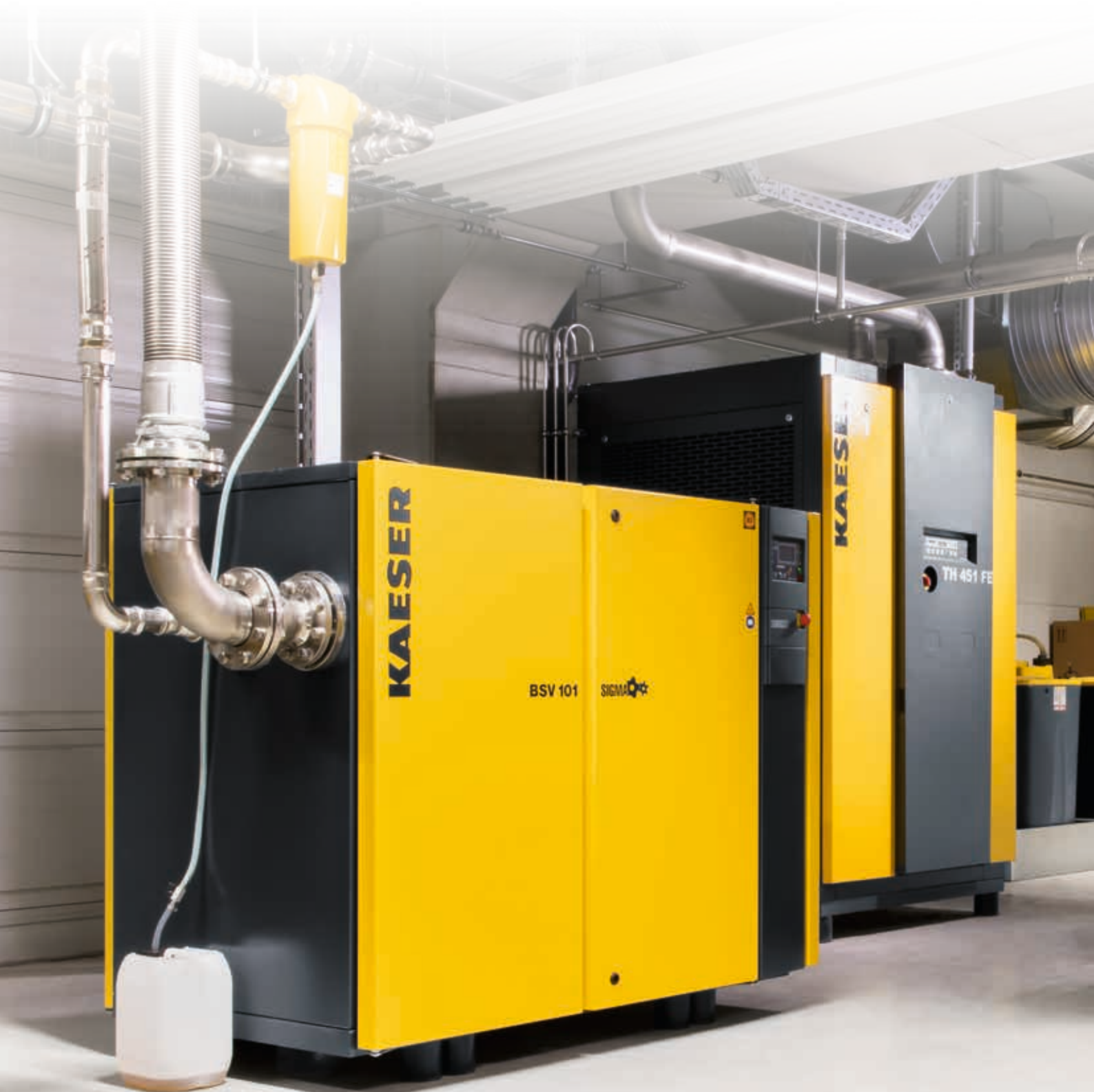
Stazione di vuoto con BSV 101
